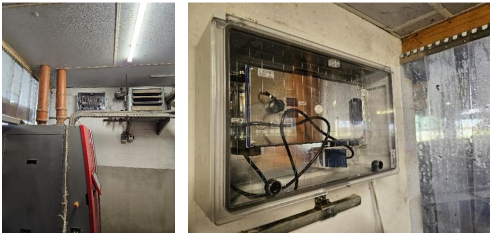
Abbildung 13: Installation der Gaschromatographen (Sniffer) im Praxisbetrieb
